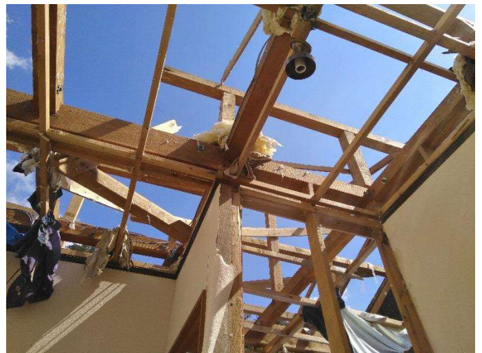
台風15号で屋根が吹き飛ばされたお宅（鋸南町）
