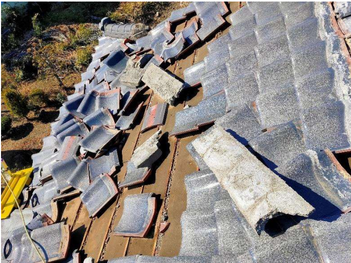
昨年の福島県沖地震で被災したお宅（新地町）
